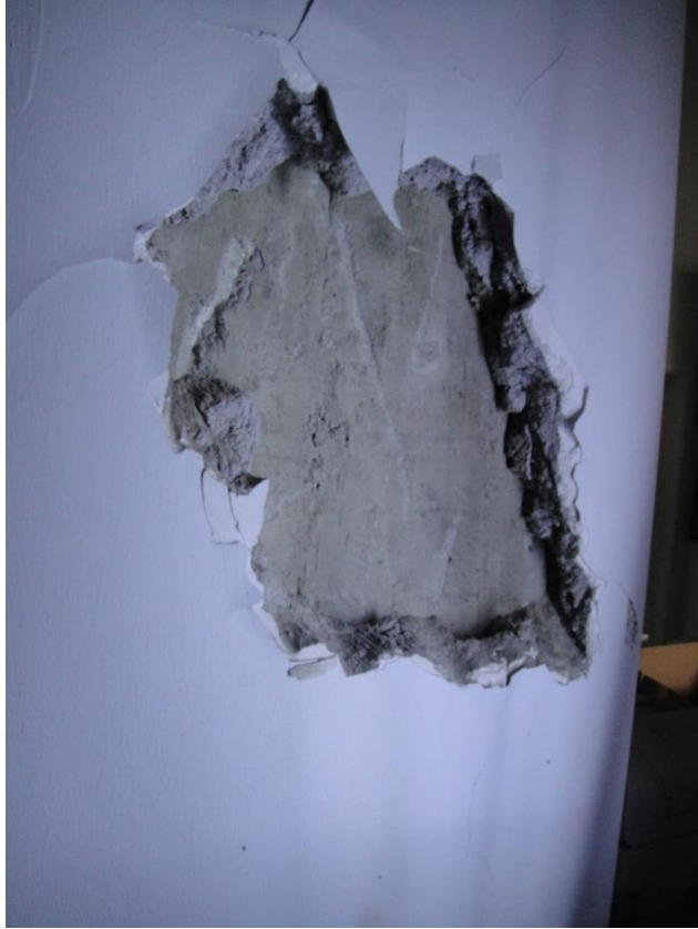
Sıva üzerindeki çatlak beton yüzeyinde devam etmemekte.
