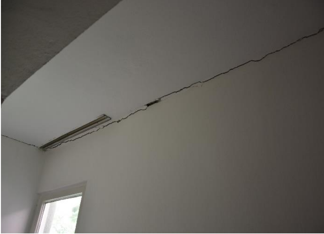
Duvar-asma tavan ayrılması
