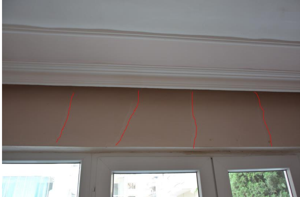
Kirişte etriye hizalarında sıva üzeri çatlaklar.
